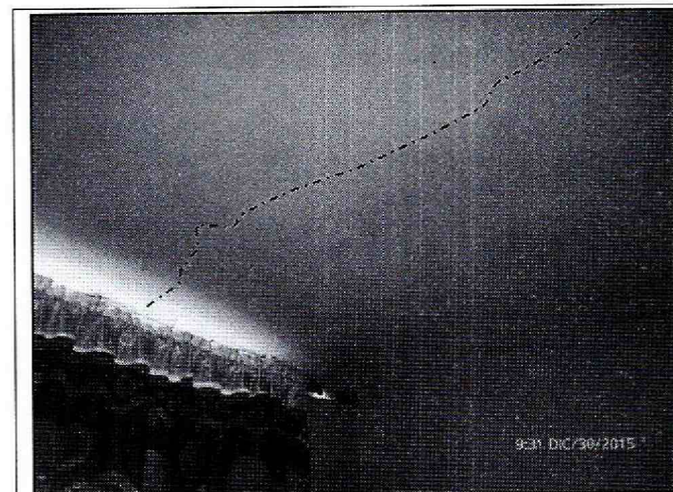
Fotografía 3. Vista de la cara inferior de la placa de entpiso en la que se observa una fisura de tendencia longitudinal, la cual no compromete la estabilidad estructural y habitabilidad de la misma.
