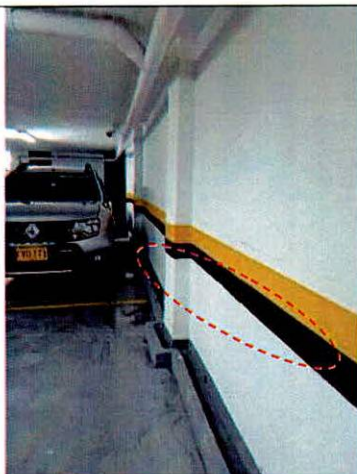
Fotografía 4. . Estado de la placa de entre piso del antejardín del predio evaluado
