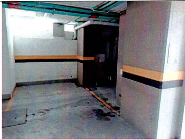
Fotografía 5. Filtraciones de agua en el costado occidental del sótano de parqueaderos.
