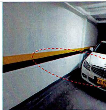
Fotografía 3. Manchas de humedad en los muros perimetrales del sótano de parqueaderos
