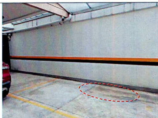
Fotografía 2. Manchas de humedad sobre la base de los muros perimetrales del costado occidental del sótano de parqueaderos.
