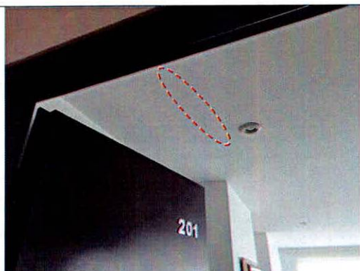
Fotografía 10. Fisuras longitudinales en el recubrimiento de la placa de entrepiso
