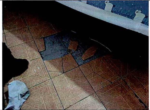
Fotografía 6. Ruptura de acabados de entepiso en el segundo nivel del costado posterior del predio P1
