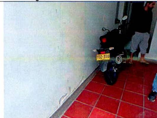
Fotografía 9. Humedad de la base los muros perimetrales de la edificación de P1.
