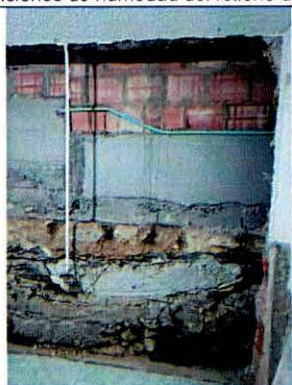
Fotografía 6. Humedad en la base del relleno de P2
