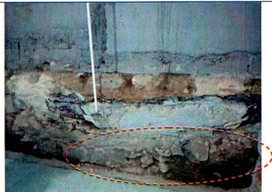
Fotografía 5. Humedad en la base del relleno de P2
