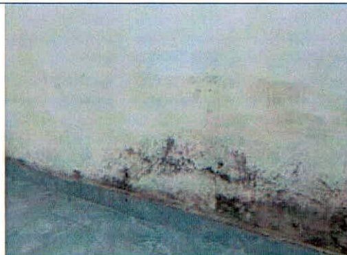
Fotografía 10. Humedad de la base los muros perimetrales de la edificación de P1.
