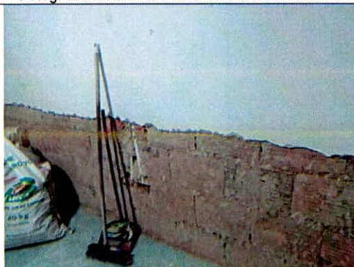
Fotografía 8. Huemdad en la base de los muros perimetrales del primer nivel de la edificación
