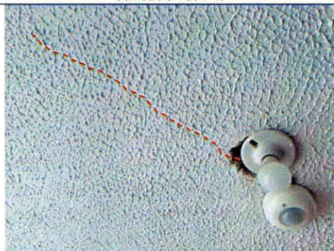
Fotografía 12. Fisuras longitudinales en la placa de entepiso del segundo nivel de P2.
