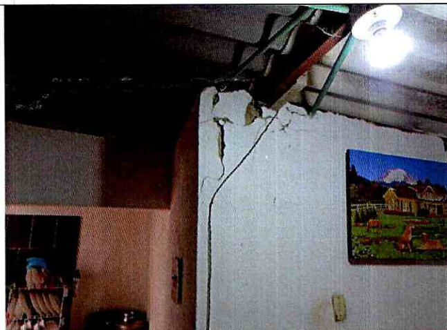
Fotografía 7. Grietas en muro de mampostería del predio P2
