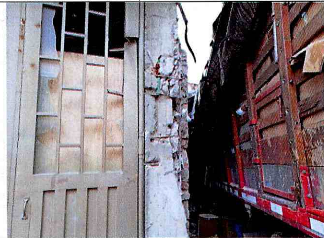
Fotografía 10. Columna afectada en el predio P2
