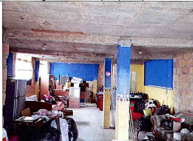
Fotografía 5. Vigas de sentido sur-norte con flexión en predio P2
