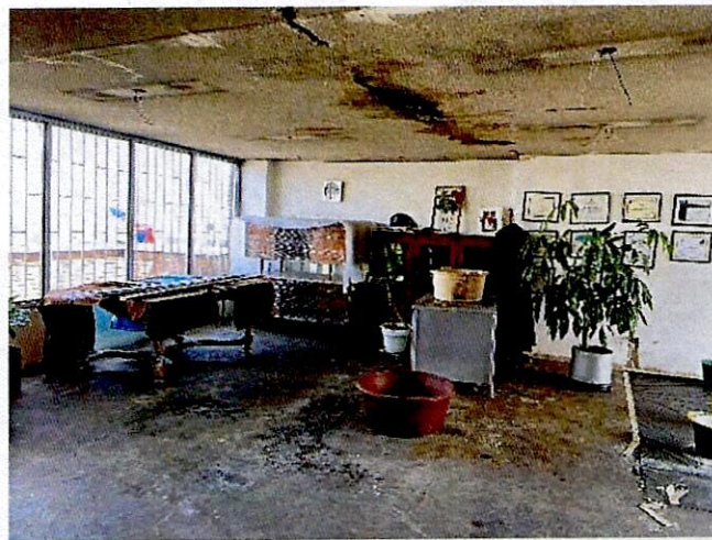
Fotografías 4. Daños identificados al interior de la oficina 1201 predio evaluado.
