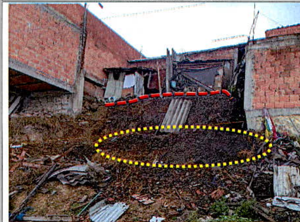
Fotografía No. 3. Vista del talud inspeccionado donde se presentó el deslizamiento y el material desplazado.
