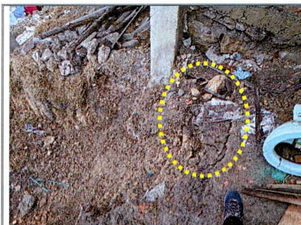
Fotografía No. 5. Vista de las grietas de tracción en el patio de la vivienda emplazada el predio evaluado.
