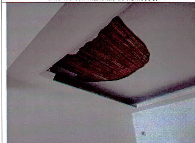
Fotografía 5. Desprendimientos del cielo raso en la zona del comedor.
