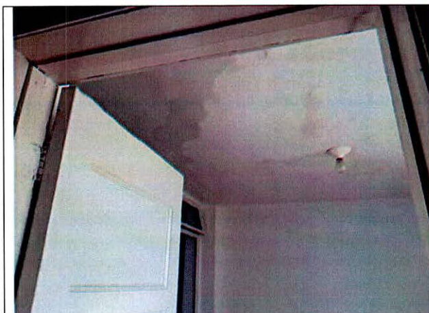
Fotografía 9. Manchas de humedad del cielo raso de la habitación central del segundo nivel.
