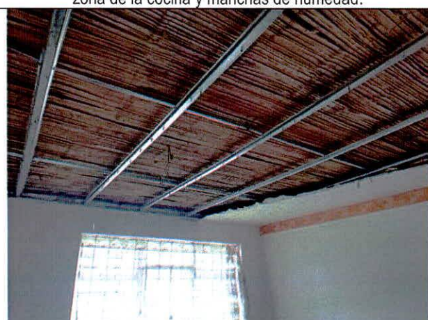
Fotografía 8. Desprendimiento del cielo raso de la habitación del costado noroccidental del segundo nivel.
