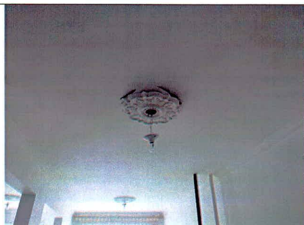
Fotografía 4. Desprendimiento de apliques del cielo raso en la zona de la sala y manchas de humedad.
