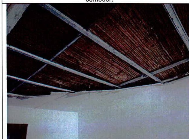
Fotografía 7. Desprendimiento del cielo raso de la habitación del costado nororiental del segundo nivel.
