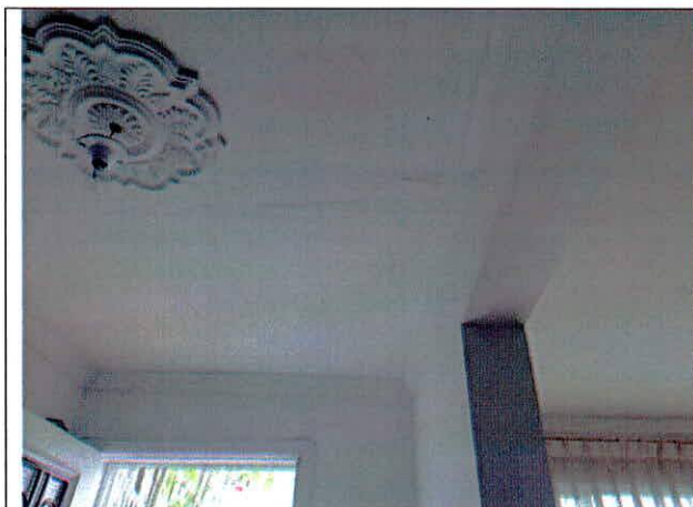
Fotografía 3. Fisura en el cielo raso de la entrada de la vivienda con manchas de humedad.
