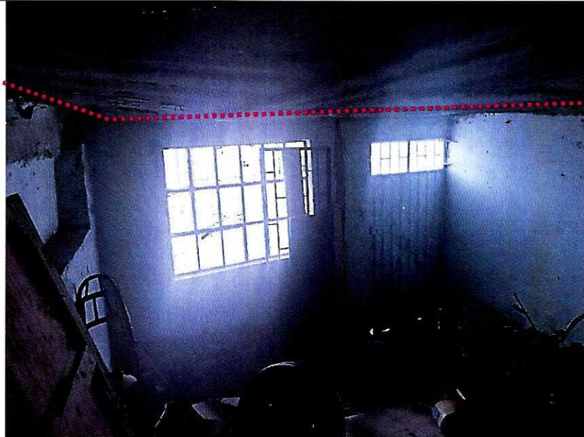
Fotografía 5 y 6. Pandeo de la placa entrepiso entre el primer y segundo nivel.
