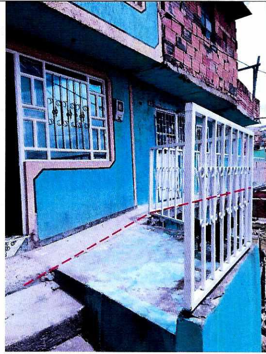
Fotografía 8. Inclinación hacia el occidente de la estructura de la vivienda.
