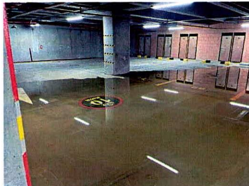
Fotografía 4. Empozamiento de agua a nivel de sótanos del predio evaluado.
