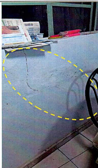
Fotografía 6. Fisuras observadas en muros de la zona media del primer nivel de la vivienda del predio de la Transversal 15 Este No. 17 C - 52 Sur.
