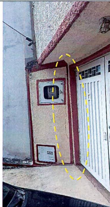
Fotografía 10. Fisura observada en murete de fachada donde se encuentran instalados el medidor de energía y gas natural
