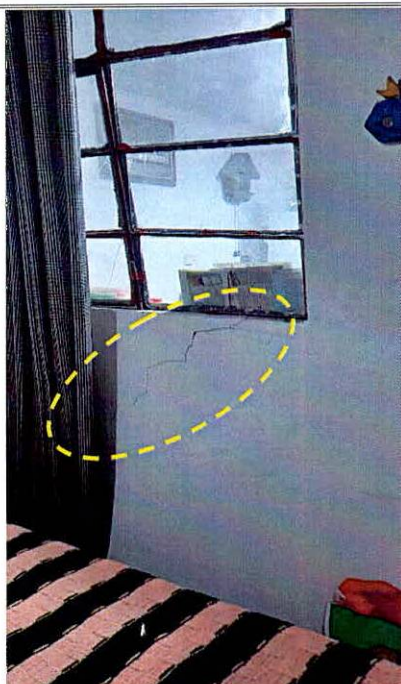
Fotografía 7. Fisuras observadas en muros de la zona media del primer nivel de la vivienda del predio de la Transversal 15 Este No. 17 C - 52 Sur.
