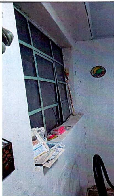
Fotografía 8. Ventana con deformaciones ubicada en primer nivel de la vivienda del predio de la Transversal 15 Este No. 17 C - 52 Sur.
