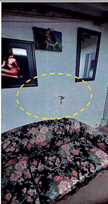
Fotografía 9. Fisuras observadas en muros de la zona media del segundo nivel de la vivienda del predio de la Transversal 15 Este No. 17 C - 52 Sur.
