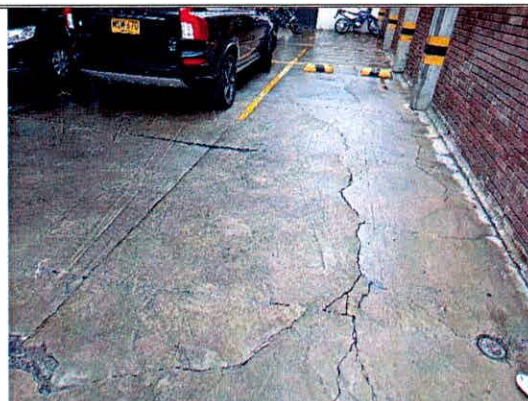
Fotografía No. 8. Vista del piso del estacionamiento donde se observan grietas y desniveles en los predios evaluados.
