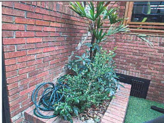
Fotografía No. 6. Vista del muro perimetral en la terraza del segundo nivel en el "Spinning Center Gym" donde se observa una grieta.
