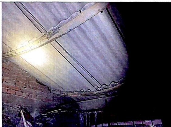
Fotografía 6. Viga metálica que soporta la cubierta, deformada con posibilidad de colapso en el sector del patio de ropas.
