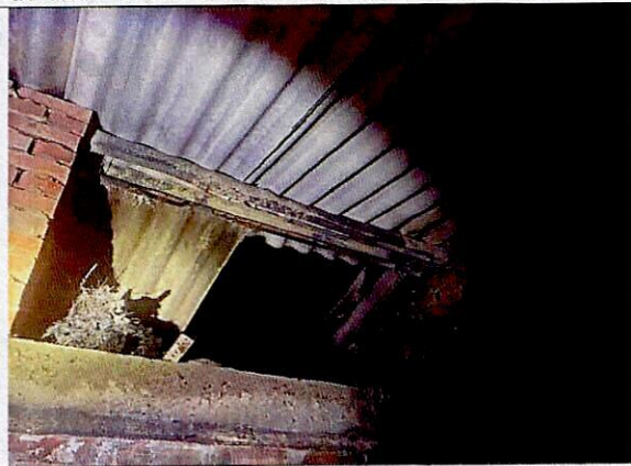
Fotografía 4. Caída de tejas de la cubierta, sector cocina y habitaciones.
