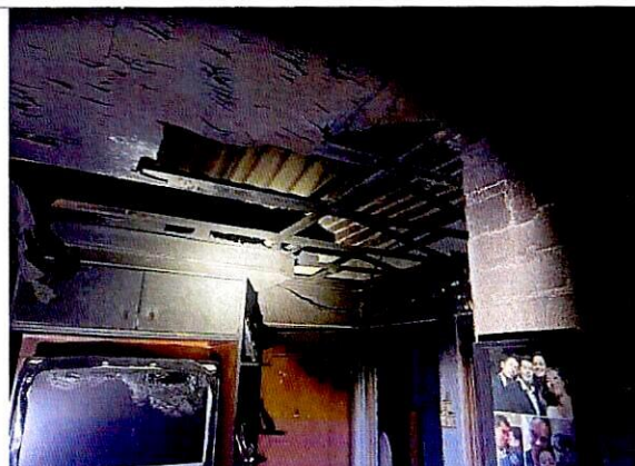
Fotografía 5. Caída de tejas de la cubierta y daños en cielo raso.
