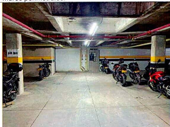
Fotografía 7. Columnas y vigas con presencia de manchas de humedad.
