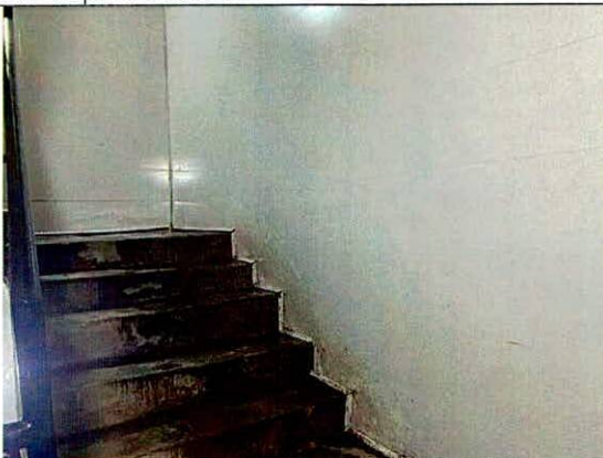
Fotografía 8. Sector de las escaleras de acceso a los sótanos con presencia de humedad.
