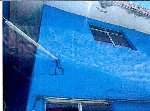
Fotografía 4. Vista de las afectaciones al interior de las viviendas
