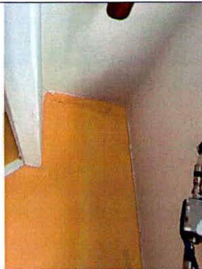
Fotografía 5. Vista de las afectaciones al interior de las viviendas
