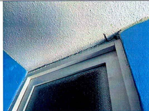
Fotografía 6. Vista de las afectaciones al interior de las viviendas
