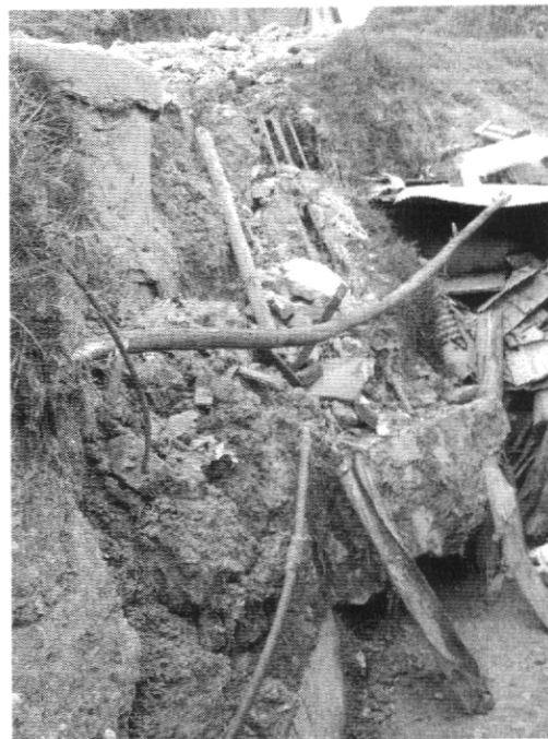
Fotografía 2. Detalle del material inestabilizado. Se observa la cámara de inspección parcialmente desconfinada y el muro en piedra colapsado
