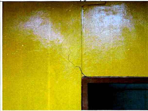
Foto 11. Grietas y deterioro de muros del sector posterior.
