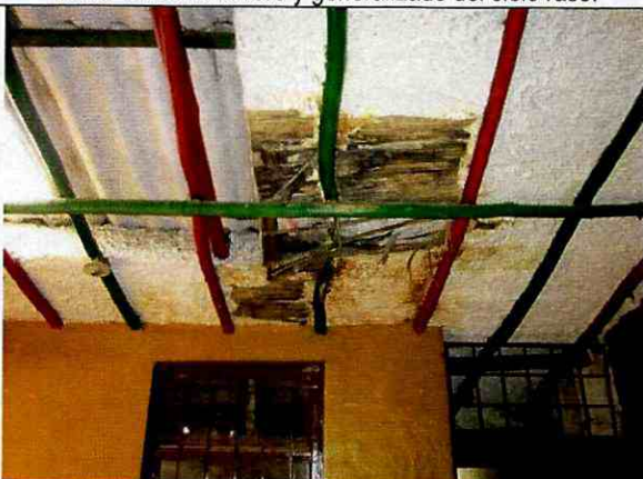
Foto 27. Deterioro y daño del cielo raso.
