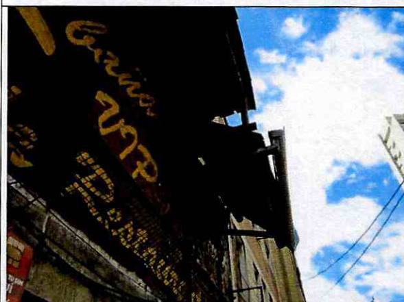
Foto 3. Deterioro de los elementos de madera del alero.
