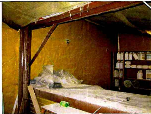
Foto 7. Muros del sector medio del inmueble, fisuras.
