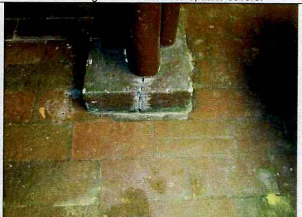
Foto 18. Daño en punto de apoyo de los postes de madera.
