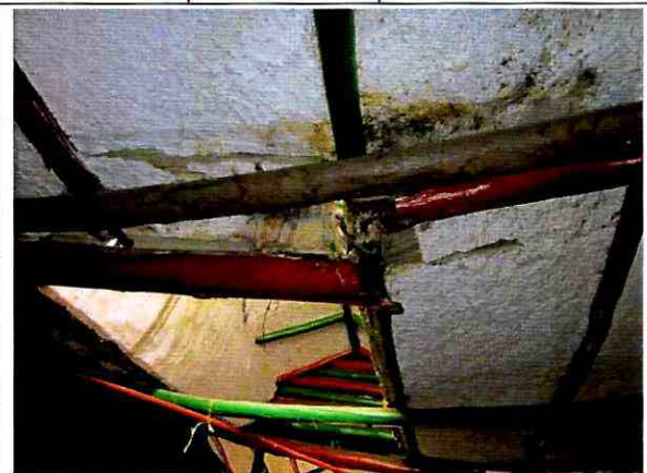
Foto 22. Fractura de elementos de la cubierta, sector medio.
