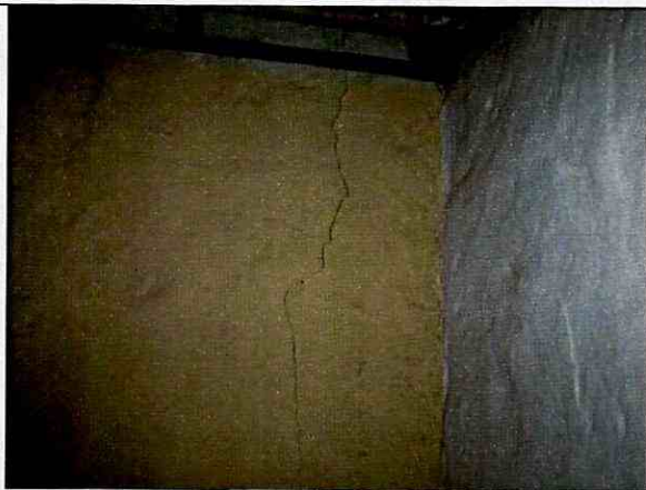
Foto 13. Grieta de sentido vertical en muro.
