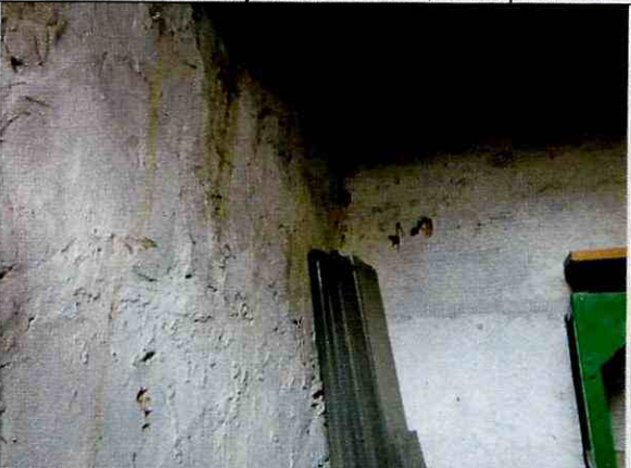
Foto 17. Deterioro de los acabados por exceso de humedad.
