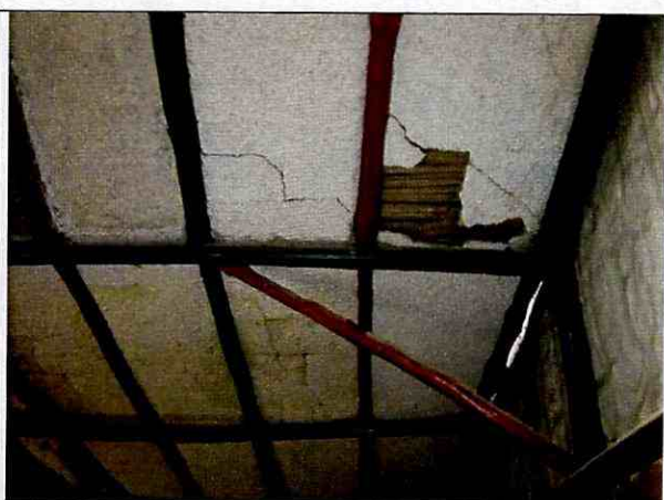
Foto 26. Desprendimientos del recubrimiento del cielo raso.
