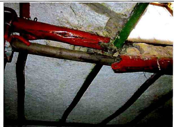
Foto 24. Daño severo de la estructura de cubierta.
