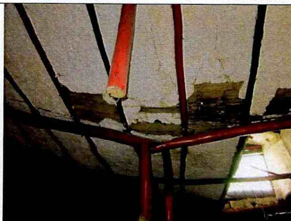
Foto 25. Daño severo y generalizado del cielo raso.
