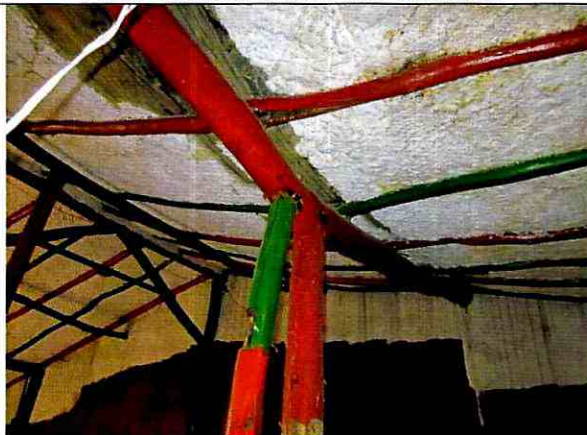
Foto 23. Deformación excesiva de elementos de cubierta.
