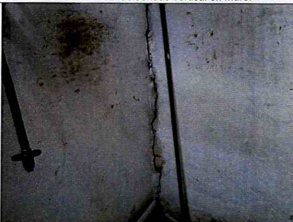
Foto 15. Grieta en la junta entre muros, sector posterior.
