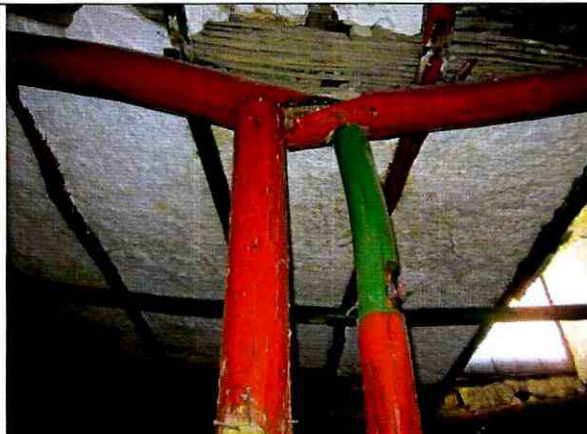
Foto 21. Daño de los elementos de cubierta.
