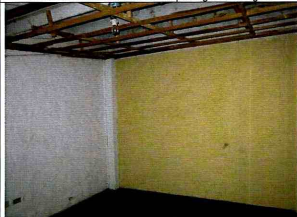
Foto 12. Fisuras y grietas en muros del sector posterior.
