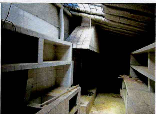
Foto 6. Muros del sector frontal, buen estado con deterioro.
