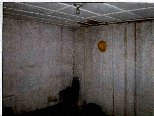
Foto 14. Deterioro de acabados por escurrimiento de agua.
