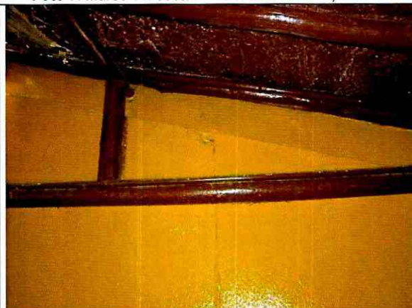
Foto 9. Muros con fisuras y grietas, sector medio.
