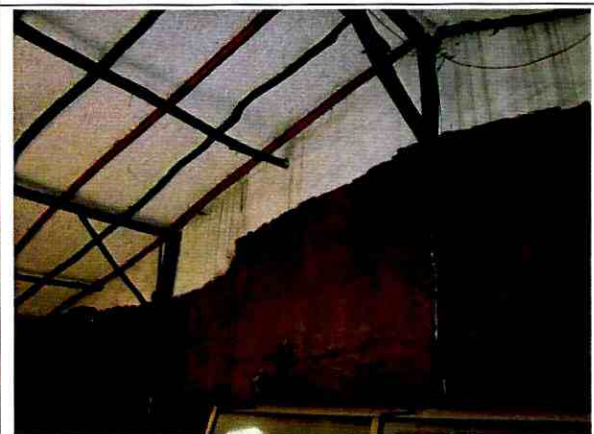
Foto 10. Evidencia de deterioro por ingreso de agua.
