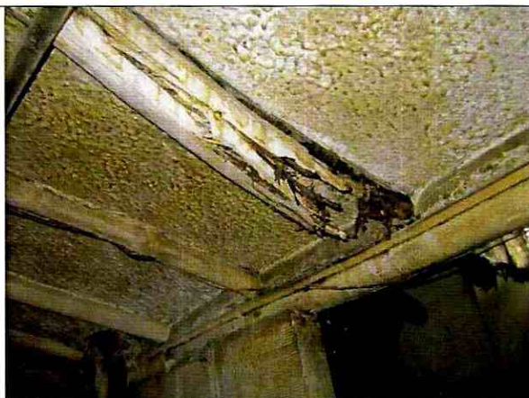
Foto 19. Fractura de elementos de cubierta, sector frontal.
