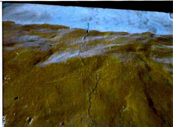
Foto 8. Fisuras en muros del sector medio.
