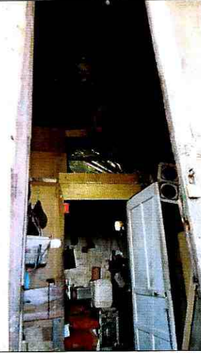
Fotografía 4. Vista del mal estado de la cubierta en habitación de la parte posterior de la vivienda.
