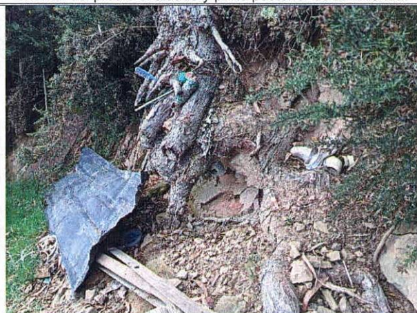
Fotografía No. 6. Vista de la zona de las raíces del individuo arbóreo localizado en la parte alta del talud evaluado.
