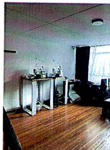
Fotografía 10. Desniveles en placa de entrepiso predio P2.
