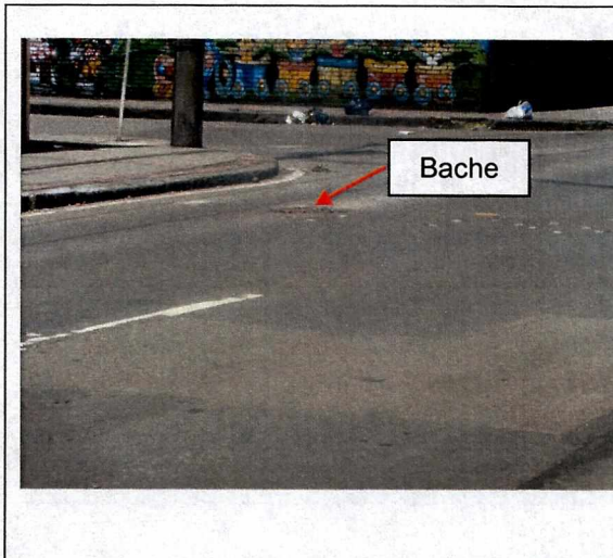
Fotografía 3. Bache en el pavimento flexible, a la altura de la Calle 28 Sur con Carrera 21.
