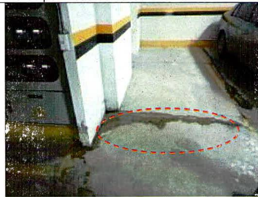
Fotografía 6. Filtraciones de agua en la base de los muros perimetrales del costado oriental del sótano
