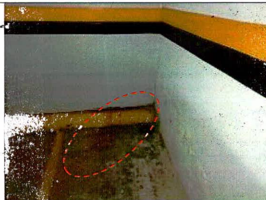
Fotografía 4. Filtraciones de agua en la base de los muros perimetrales del costado oriental del sótano
