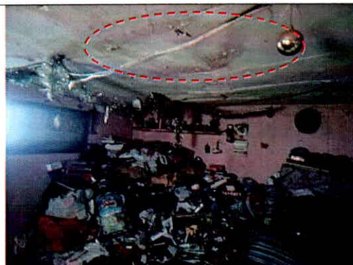
Fotografía 3. Daños en los elementos de cielo raso al interior de la vivienda. (Filtraciones y deformaciones de la placa de cubierta),
