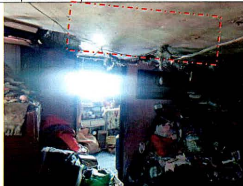
Fotografía 4 Daños en los elementos de cielo raso y deformaciones de la placa de cubierta de la vivienda evaluada.
