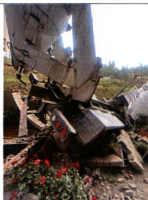
Fotografía 6. Vista desde las oficinas afectadas
