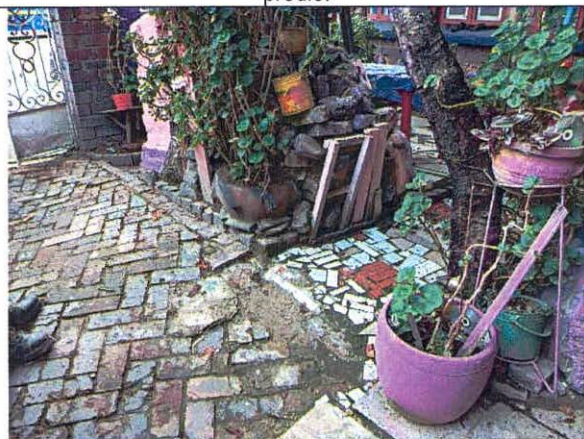
Fotografía 5. Levantamiento y fisuras en adoquines de zona peatonal al costado nororiental.
