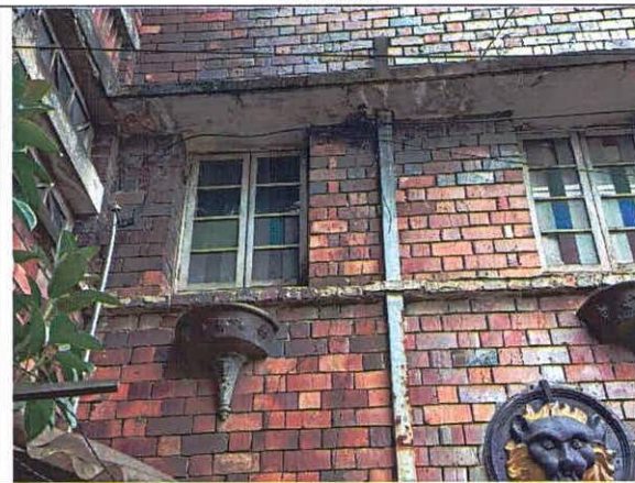
Fotografía 6. Problemas de humedad en cara inferior de aleros en concreto.
