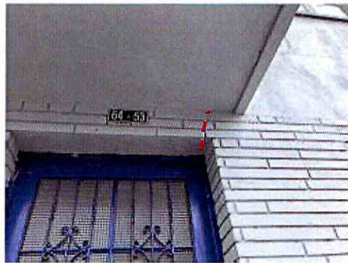
Fotografía 15. Fisura en elementos de fachada predio P5.
