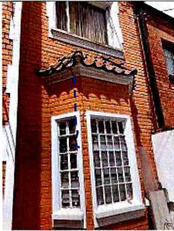
Fotografía 3. Fisura en algunos mampuestos localizados en fachada predio P2.
