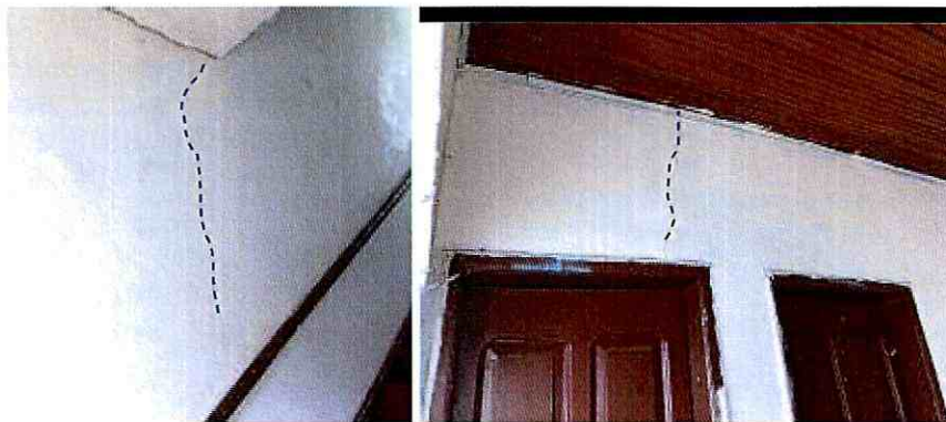
Fotografías 5 y 6. Fisuras en muros perimetrales e interiores predio P2.
