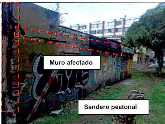
Fotografía 5. Daños en el muro perimetral del costado posterior de la edificación y sendero adyacente.
