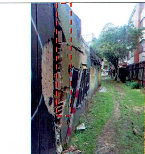
Fotografía 6. Daños en el muro perimetral del costado posterior de la edificación y sendero adyacente.
