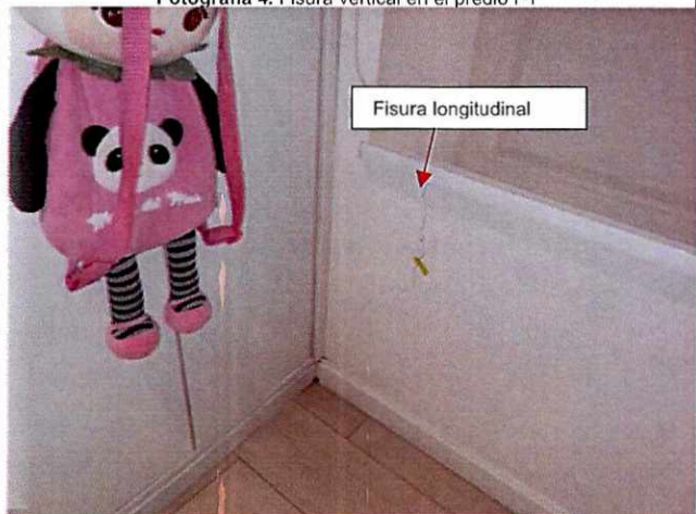
Fotografía 5. Fisura vertical en el predio P1
