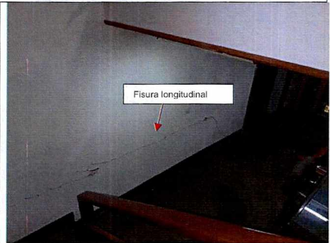
Fotografía 12. Fisura horizontal en el predio P3
