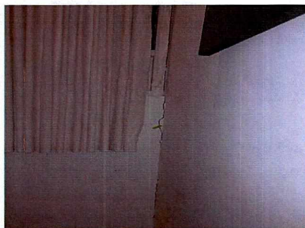
Fotografía 2. Fisura vertical en predio P1
