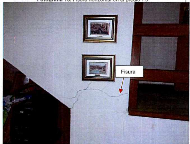
Fotografía 14. Fisura con tendencia irregular en el predio P3
