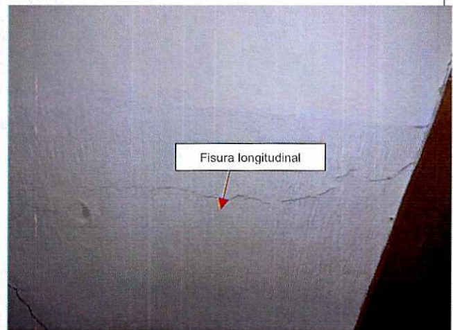
Fotografía 13. Fisura horizontal en el predio P3
