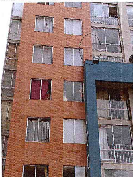
Foto No. 3. Segmentos de fachaleta con posibilidad de caída, los cuales de presentarse se depositarían sobre el pórtico arquitectónico localizado en la parte inferior
