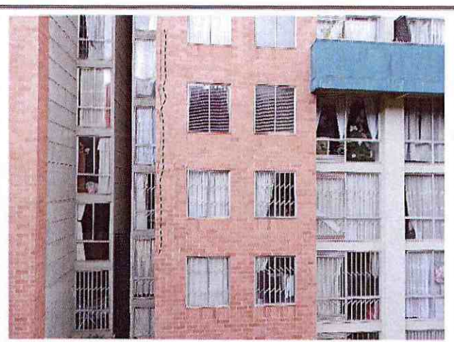
Foto No. 2. Evidencia de algunos agrietamientos evidenciados sobre la fachaleta de las torres
