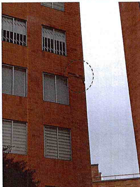
Foto No. 4. Vista de sectores en los cuales ya se ha presentado la caída de segmentos de la fachaleta.
