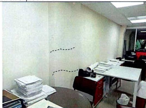
Fotografía 4. Daños identificados en los muros perimetrales
