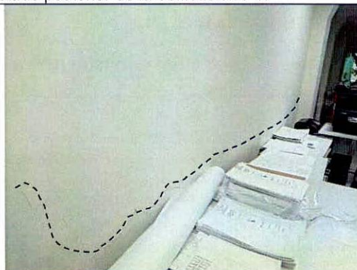
Fotografía 5. Daños identificados en los muros perimetrales
