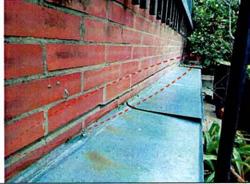
Fotografía 7. Daños en la estructura del muro de cerramiento perimetral del costado oriental del predio P2 (visto desde P1).
