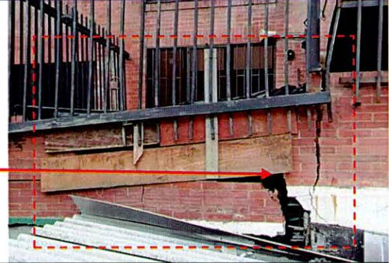
Fotografía 9. Daños en la estructura del muro de cerramiento perimetral del costado oriental del predio P2 (visto desde P1).
