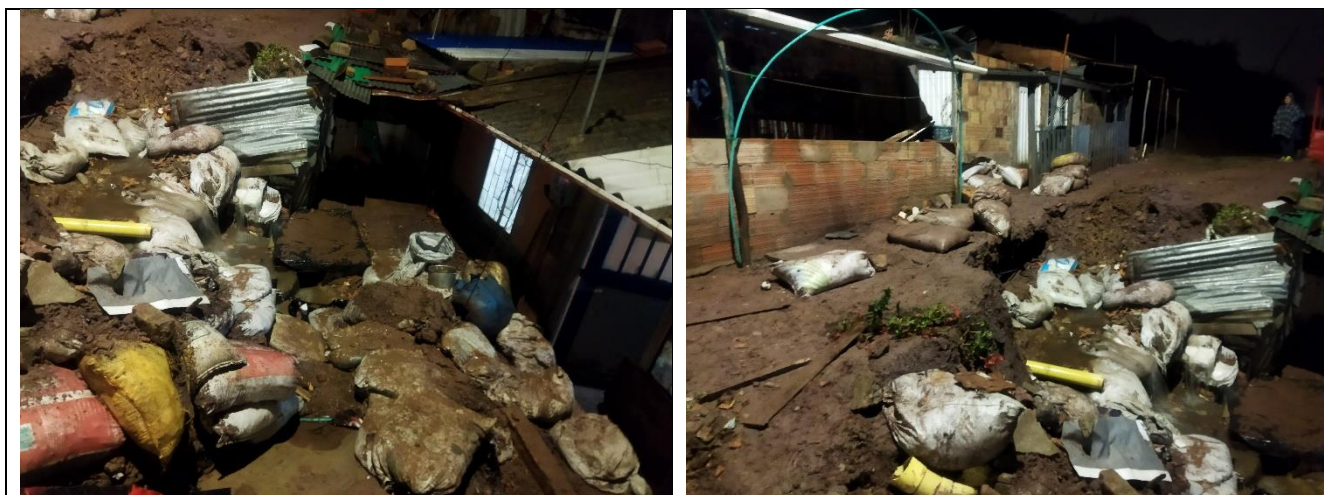
Fotografía 3 -4. Perdida de material de la banca de la vía y caída al predio (P1) (19/11/2023)
