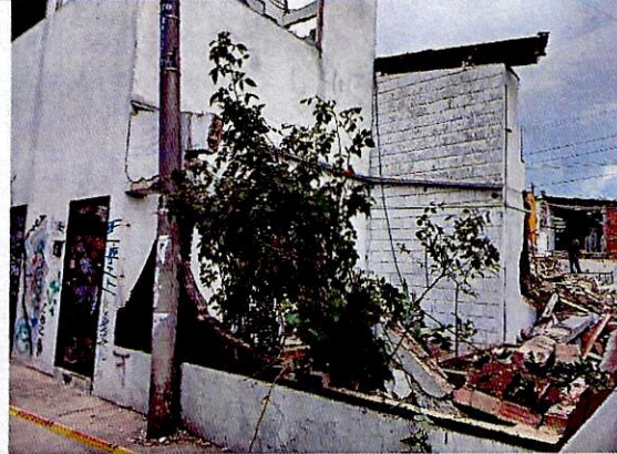
Fotografía 6. Muro perimetral Suroccidental parcialmente colapsado.
