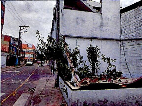
Fotografía 5. Muro perimetral Suroccidental parcialmente colapsado.
