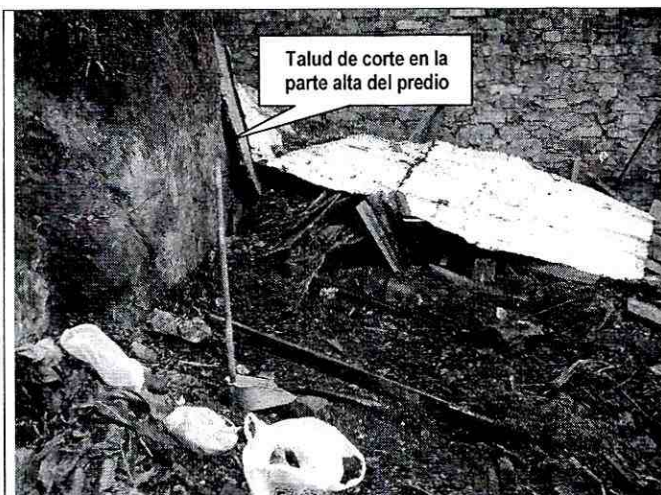
Foto 1. Aspecto del terreno en la parte alta del predio de la Calle 32A Bis Sur # 15-78, en el que se emplazaba la unidad en madera que colapsó.
