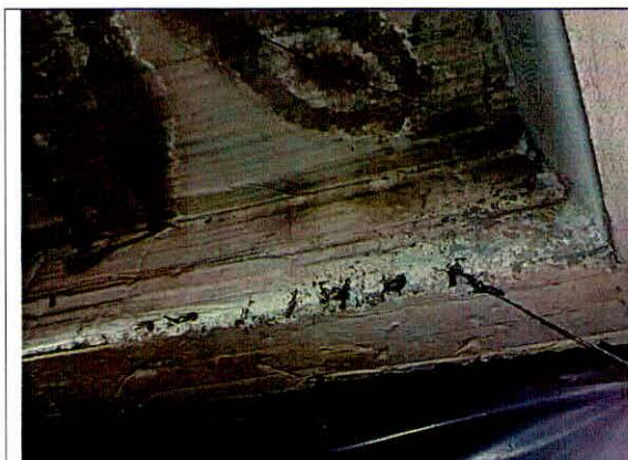
Fotografía 5. Irregularidades en el acabado de la superficie en concreto
