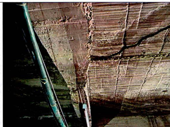
Fotografía 6. Irregularidades en el acabado de la superficie en concreto.
