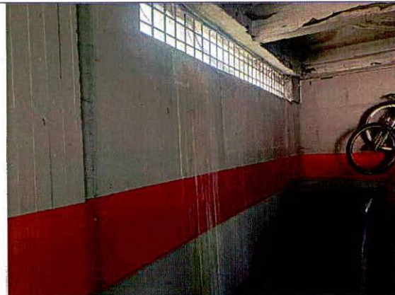
Fotografía 4. Sectores con presencia de humedades sobre el muro.
