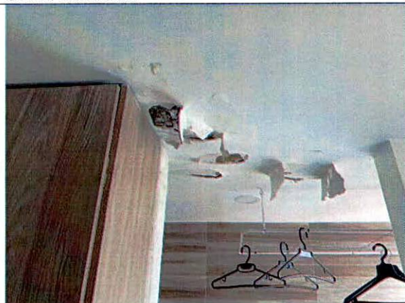
Fotografía 6. Humedades en el techo de la cocina. Desprendimientos de recubrimiento en pintura.
