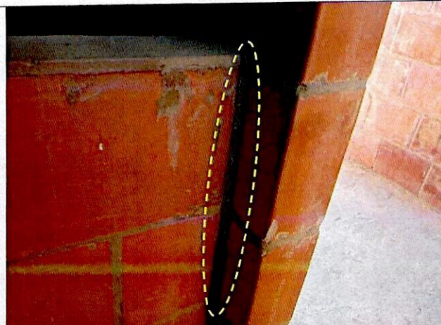
Fotografía 6. Fisura tendencia vertical en muro torre F, quinto nivel.
