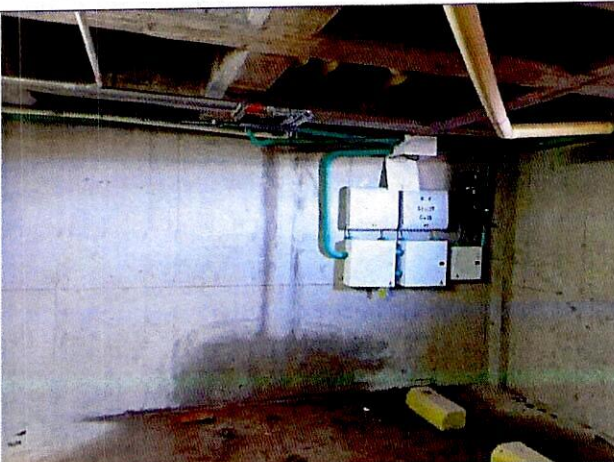
Fotografía 5. Filtración de agua, costado oriental del sótano.
