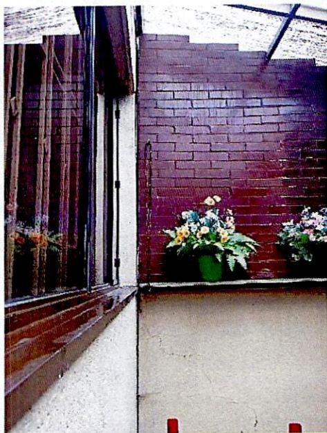
Fotografía 19. Separación de muro perimetral patio y muro interno predio P1 apartamento 102 predio P1 (Fotografía tomada del diagnóstico técnico DI-18781)
