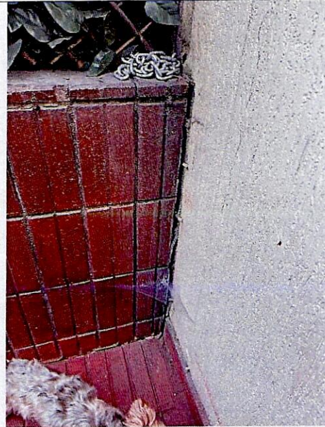
Fotografía 14. Dilataciones en muros de zona de jardín costado oriental en muros interiores de zona de patio apartamento 101 predio P1 (Fotografía tomada el 04 de enero de 2024)
