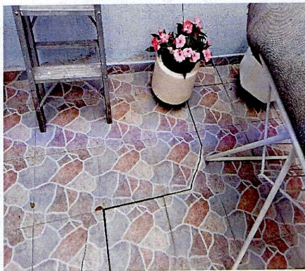
Fotografía 20. Asentamientos diferenciales en placa primer nivel del predio P1 apartamento 102 predio P1 (Fotografía tomada del diagnóstico técnico DI-18781)
