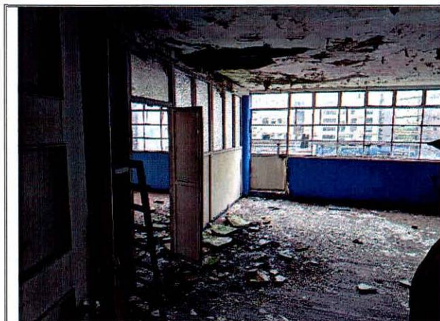
Fotografía No. 7. Vista de la humedad y desprendimiento de acabados en el cielorraso y muros del piso 5.
