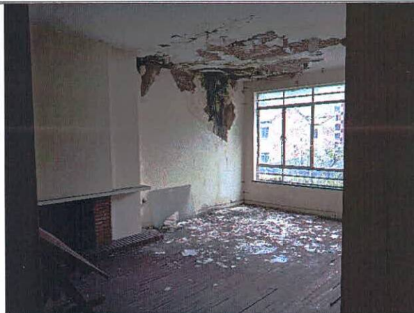
Fotografía No. 6. Vista de la humedad y desprendimiento de acabados en el cielorraso y muros del piso 4.
