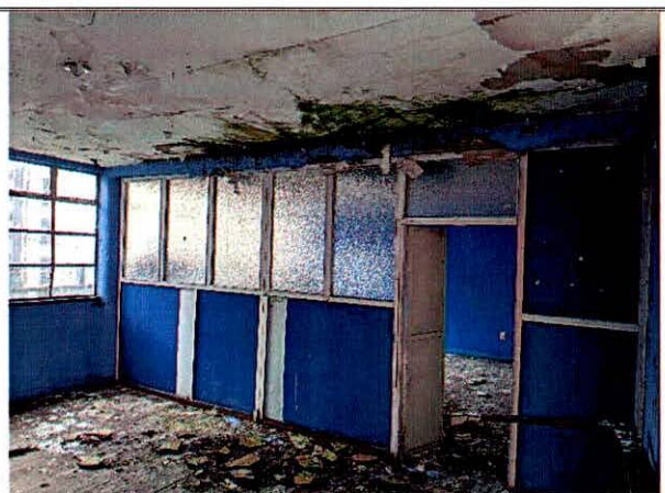
Fotografía No. 8. Vista de la humedad y desprendimiento de acabados en el cielorraso y muros del piso 5.
