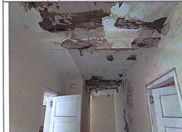
Fotografía No. 5. Vista de la humedad y desprendimiento de acabados en el cielorraso y muros del piso 4.
