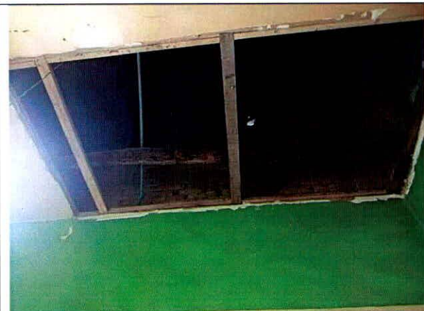
Fotografía 3. Daños en muro de adobe del costado suroccidental y del cielo raso de la cocina en la vivienda emplazada en el predio P1.
