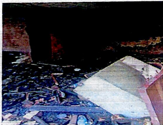
Fotografía No. 3. Vista general de restos de maderas y enseres, resultado del incendio.
