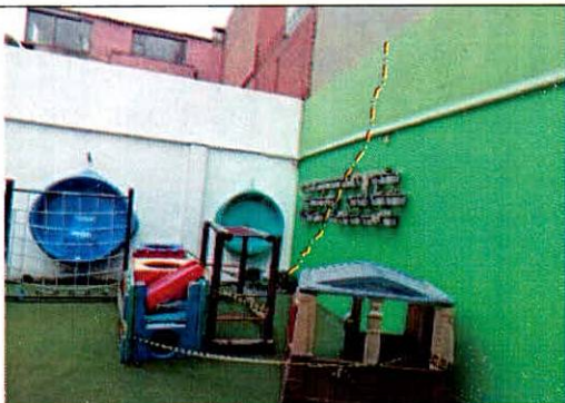
Fotografía 4. Daños identificados en los muros perimetrales del costado noroccidental del predio evaluado (Patio descubierto).
