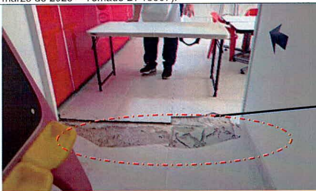
Fotografía 10. Rotura y levantamiento de losetas de piso en el segundo nivel del jardín infantil (visita del 02 de marzo de 2023 – Tomado DI-18807).
