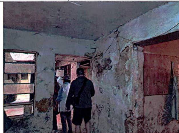
Fotografía No. 3. Vista de la humedad y la pérdida de los acabados en el cielorraso y paredes en el apartamento del primer nivel de la edificación evaluada.
