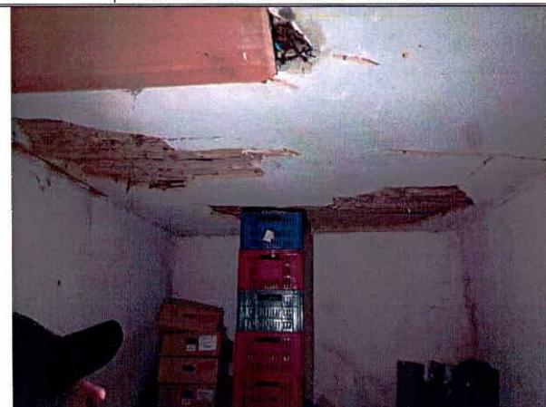
Fotografía No. 5. Vista de los desprendimientos y caída de los elementos del cielorraso en el apartamento del primer nivel de la edificación evaluada.
