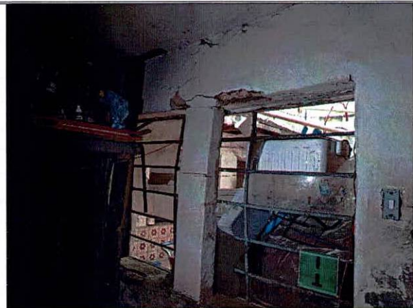
Fotografía No. 4. Vista de la fractura y pandeo del elemento no estructural en el apartamento del primer nivel de la edificación evaluada.
