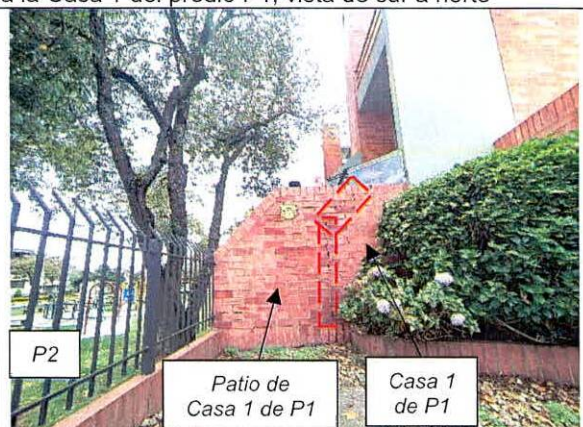
Fotografía 8. Grietas en muro divisorio sur del patio de la Casa 1 del predio P1, vista de sur a norte
