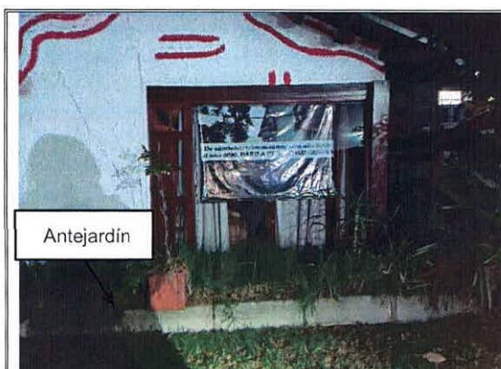
Foto 13. Vista exterior de la casa 24 ventana donde se presenta el colapso parcial, costado sur.
