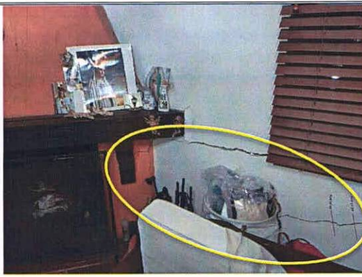
Foto 8. Vista grietas zona de comedor primer nivel (Foto tomada el 16 de marzo de 2024)
