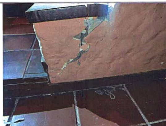
Foto 9. Vista grieta en muros divisorios primer nivel.
