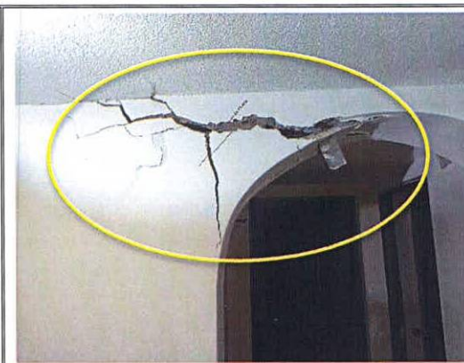
Foto 12. Vista daños en el muro divisorio segundo nivel (Foto tomada el 16 de marzo de 2024)
