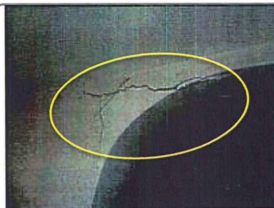
Foto 11. Vista daños en el muro divisorio segundo nivel (Foto tomada del DI-12727 de enero de 2019)
