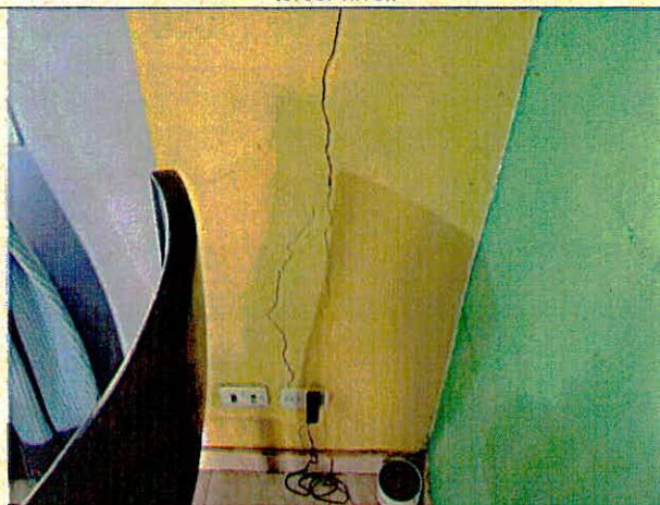
Fotografía 8. Fisura vertical en muro divisorio del apartamento del segundo nivel en el área de la sala.
