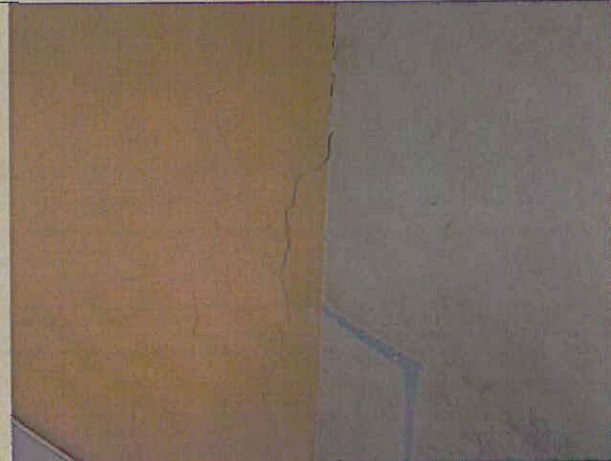
Fotografía 16. Fisura en muro divisorio de la zona del primer nivel hacia el costado sur oriental.
