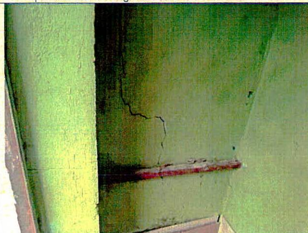
Fotografía 10. Fisura escalonada en muro divisorio del apartamento del segundo nivel.
