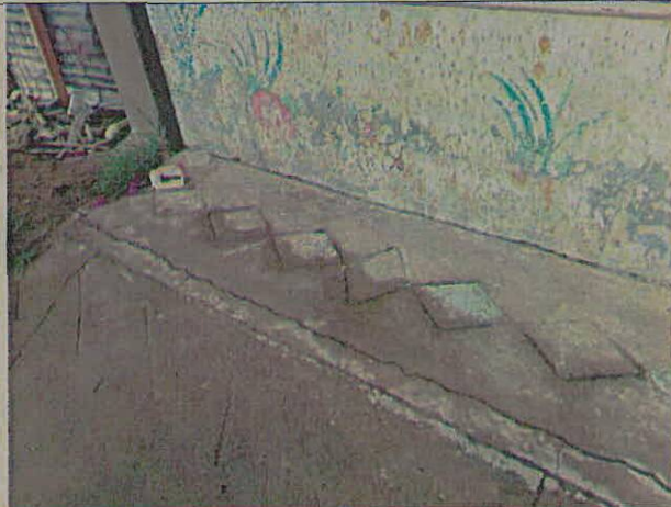
Fotografía 14. Fisura en andén en la parte exterior donde se tiene la parte posterior de la vivienda.
