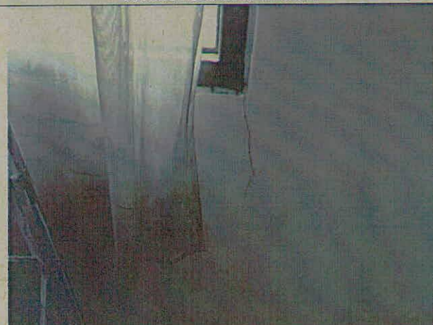
Fotografía 13. Fisura vertical en muro del apartamento del segundo nivel ubicado al costado norte de la vivienda.
