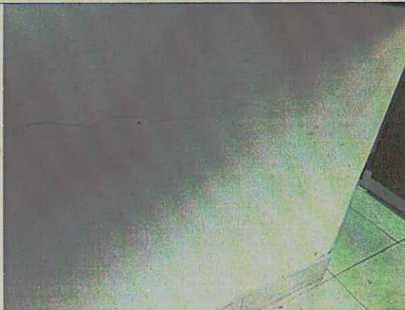
Fotografía 4. Fisura muro divisorio en el apartamento del tercer nivel.
