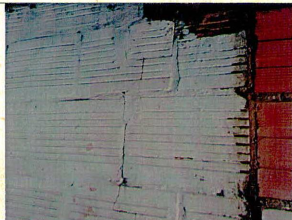
Fotografía 6. Fisura vertical en muro perimetral del costado occidental en la terraza ubicada hacia el costado norte del tercer nivel.
