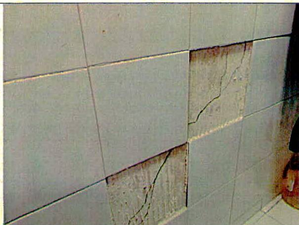
Fotografía 5. Fisura muro divisorio en el apartamento del tercer nivel ubicado al costado sur en el área de la cocina.
