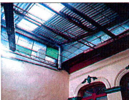
Fotografía 7. Elementos de cubierta con potencialidad de caída hacia el interior del costado posterior de la edificación.
