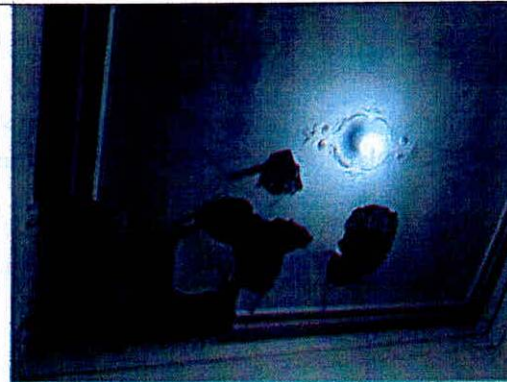
Fotografía 11. Estado del cielorraso y manchas de humedad y filtraciones en el interior de la edificación.
