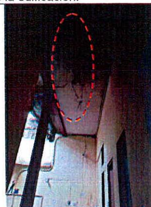
Fotografía 9. Daños en la placa de cubierta del corredor de acceso hacia el costado posterior de la edificación.
