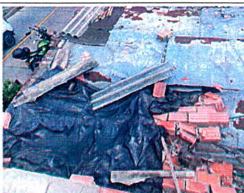
Fotografía 5 Daños en los elementos de tejado del costado posterior de la vivienda evaluada.
