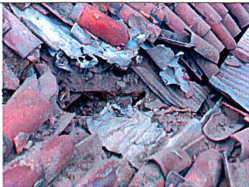
Fotografía 4. Daños en los elementos de tejado del costado posterior de la vivienda evaluada.
