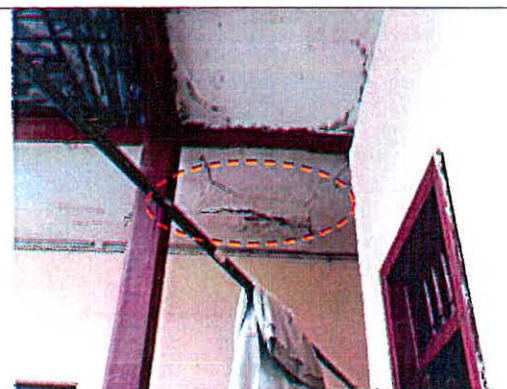
Fotografía 8. Daños en la placa de cubierta del corredor de acceso hacia el costado posterior de la edificación.
