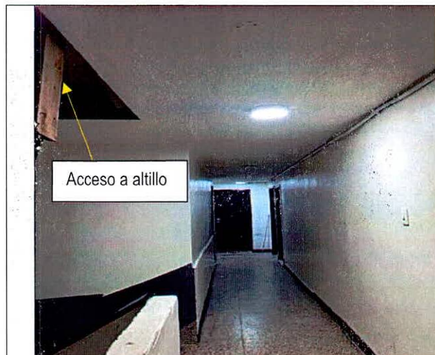
Foto 6. Placa de entrepiso 4 nivel en aparentes buenas condiciones. Se señala acceso a altillo
