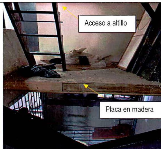
Foto 7. Placa de madera de soporte escalera para acceso a altillo
