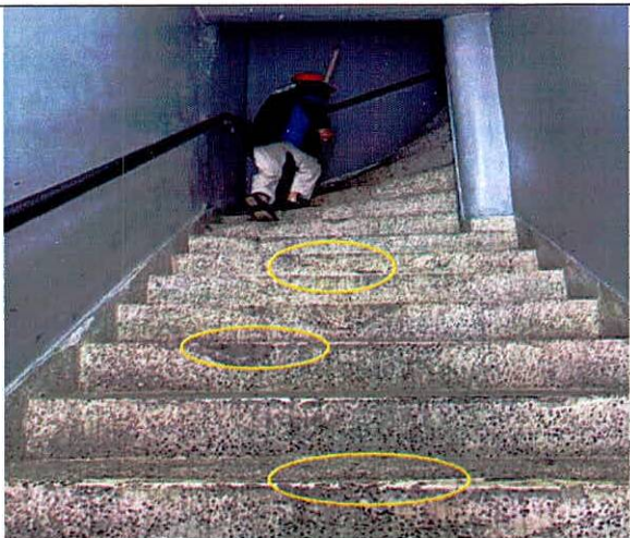
Foto 2. Daños en escaleras
