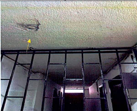
Foto 6. Puntos con pérdida de recubrimiento en placa
