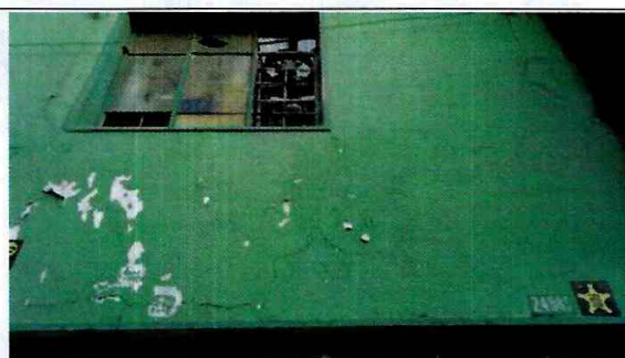
Fotografía 2. Vista de las fisuras que presenta el muro de fachada del segundo nivel.
