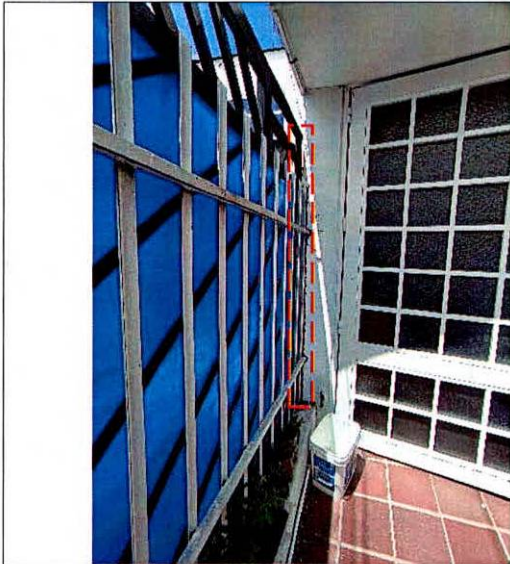
Fotografía 7. Muestra de desgarramiento en anclaje de reja perimetral norte con vivienda
