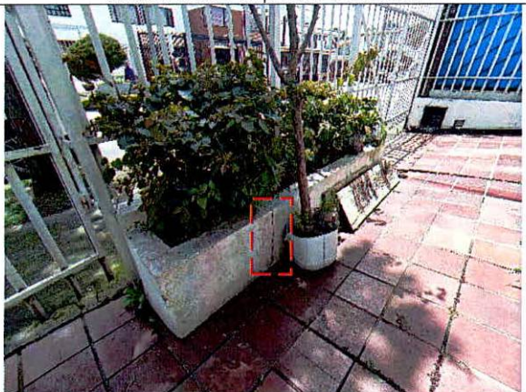
Fotografía 6. Muestra de fisuras y grietas en antepecho de materia del antejardín
