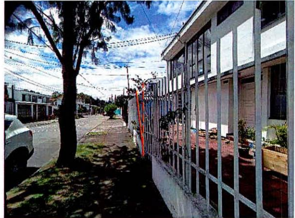
Fotografía 8. Muestra de inclinación hacia el exterior de elementos de cerramiento del predio evaluado
