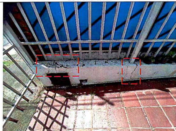
Fotografía 5. Muestra de fisuras y grietas en antepecho perimetral norte del antejardín
