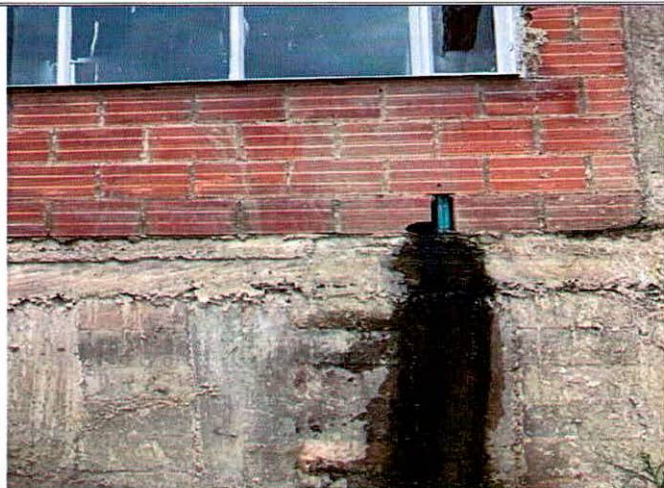
Foto No. 10. Filtraciones desde el salón comunal hacia la zona del tanque y de la casa # 5 MX 3
