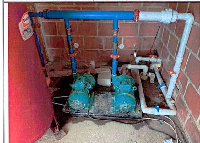
Foto No. 7. Filtraciones de tuberías en cuarto de bombeo
