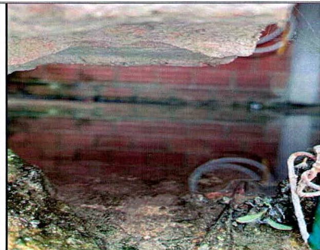
Foto No. 9. Lámina de agua de encharcamiento al interior del salón comunal
