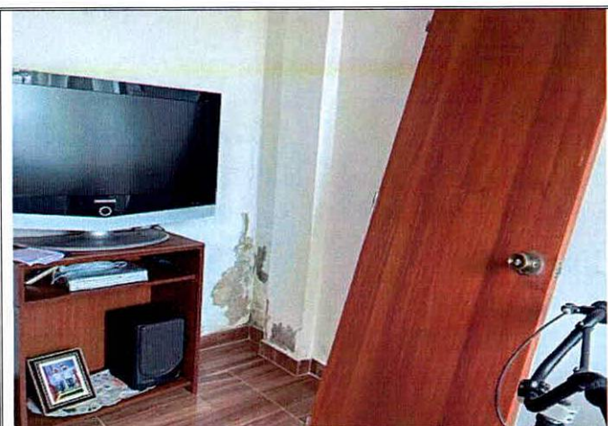
Foto No. 2. Estado del muro interno del primer nivel de la Casa # 5 MZ 3
