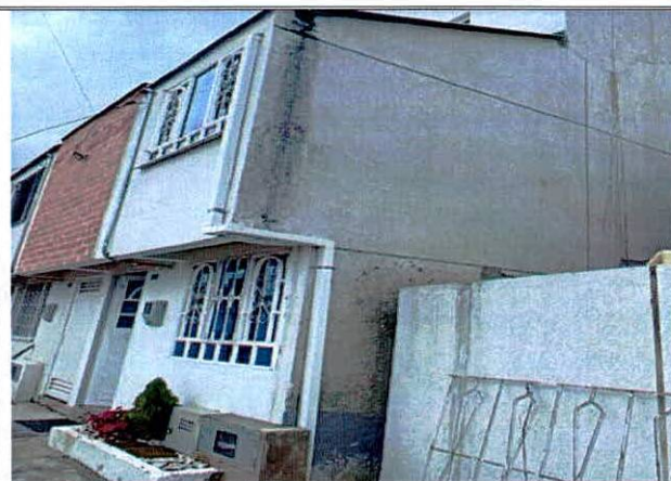
Foto No. 4. Estado del muro perimetral externo de la Casa # 5 MZ 3
